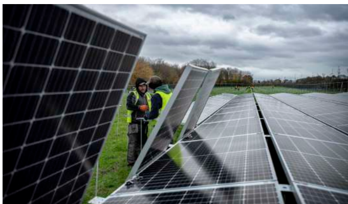
7. Zonnepark Spiesberg energiecoöperatie Peel Energie
